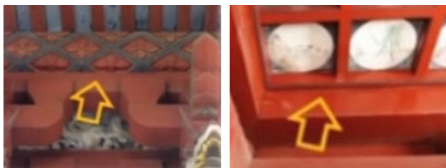
2mmの銅管を目立たないように天井付近に設置
